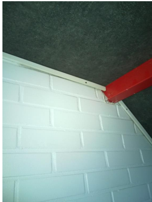
Kuva 1: Korvausilmareitti seinän ja katon liittymässä, kattoeriste mustunut ja rasvainen
