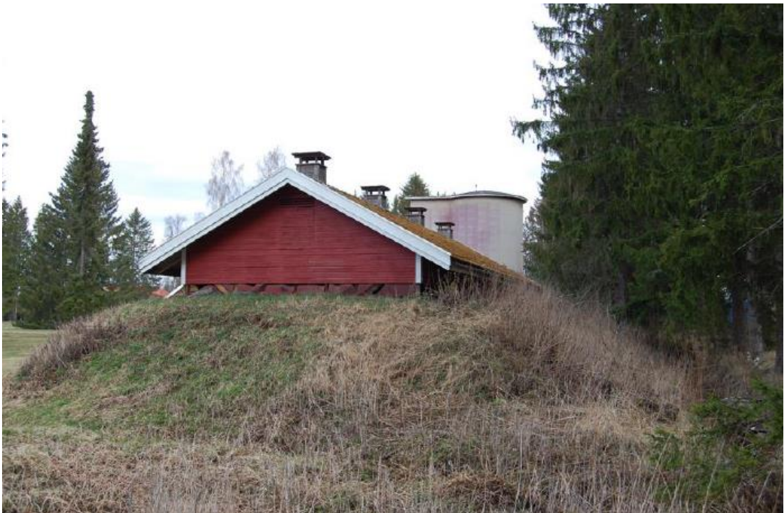
Kuva 22. Maakellari sijaitsee suojellun kuusiaidan vieressä. © Limingan Emäntäkoulun maakellarin kuntoarvion valokuvat, Konsultointi Karhulat Oy 5.6.2025
