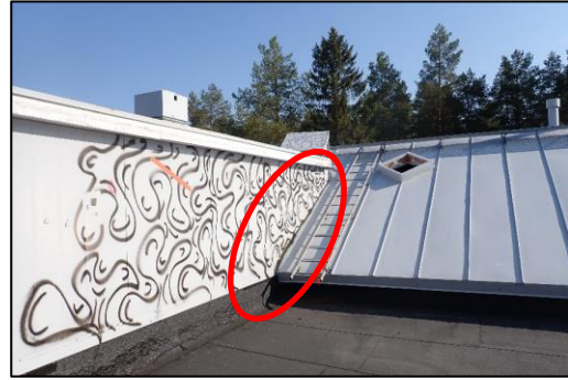
Kuva 100. Yläpohjan alapinnalla havaitut vuotojäljet aiheutuvat todennäköisesti ylösnostopellityksen tiiveyspuutteesta.
