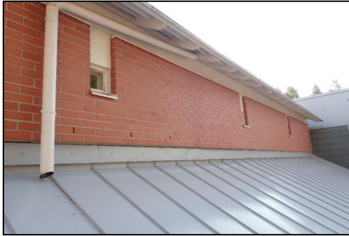
Kuva 87. Seinänostojen pellityksissä ei havaittu yleisesti puutteita.
