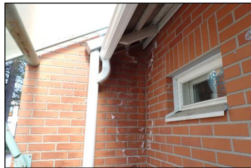
Kuva 98. Paikallinen vesikatteen vuoto seinänurkassa sisäpihan puolella.
