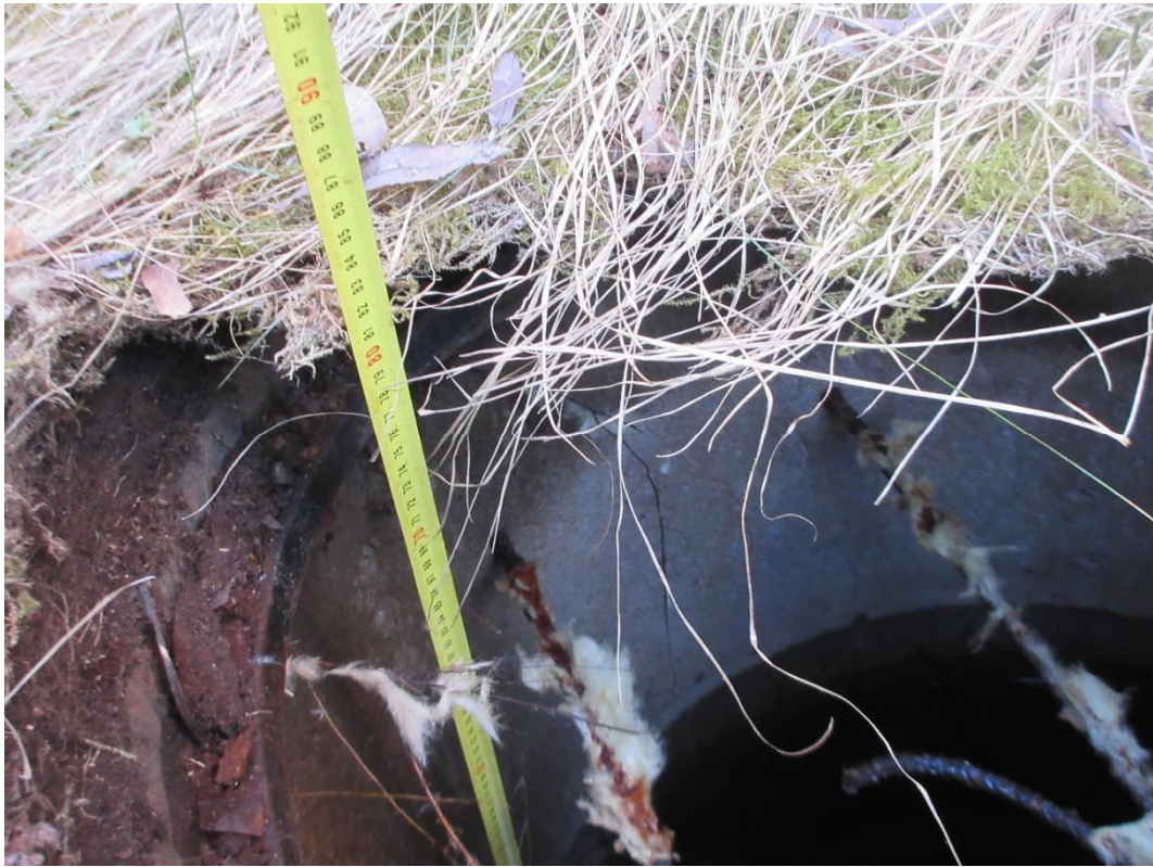
KUVA 8. Salaojakaivo SOK1 salaojaputken juoksupinnan korkeus.
