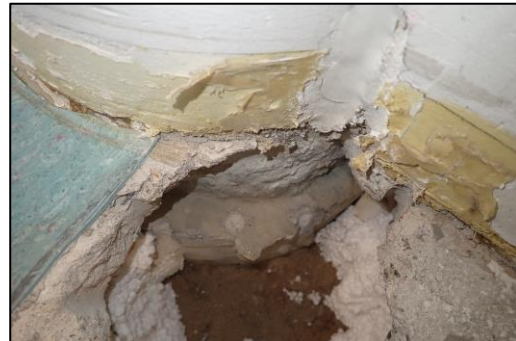
Kuva 31. RA11. Laatta on valettu pilaria vasten. Liittymän kautta ilmavuoto maaperästä sisäilmaan on mahdollista.
