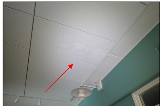
Kuva 8. Tila 218. Yläpohjan pinnalla vanhoja vesivuotojälkiä IV-konehuoneen vierustalla.
