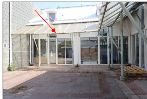
Kuva 96. Painuma-alueella valokatteen teräsrungoissa silmin havaittavaa taipumaa.
