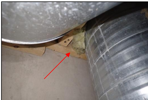
Kuva 7. Tila 108. Alakattotiloissa, läpivienneissä avoimia villapintoja.
