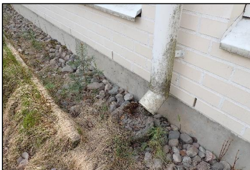
Kuva 19. Sadevedet valuvat rakennuksen vierelle. Kiveyskaistalle kasvanut nurmea ja puita.
