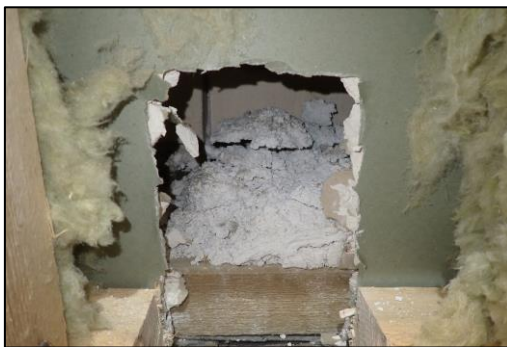
Kuva 67. RA6. Ulkomuurauksen takana runsaasti laastijätettä. Tuulettumisessa voi olla paikoin puutteita. Vaurion viitteitä ei avauskohdalla havaittu.
