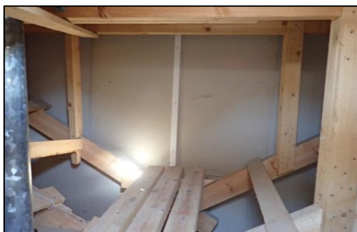
Kuva 107. Yläpohjatila jaettu palokatosastoihin. Palokatko on nostettu havaintojen mukaan vesikatteen pintaan.
