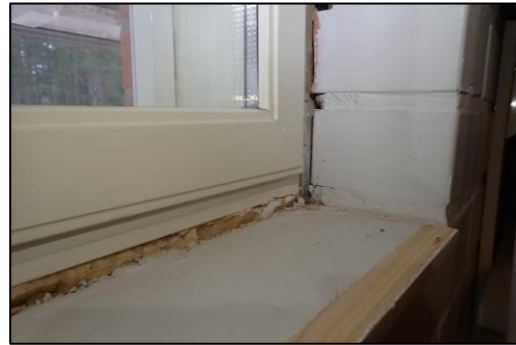
Kuva 60. RA2. Tilkkeenä polyuretaanivaaho. Ikkunakarmin ja muurauksen väli avoin eristetilaan.
