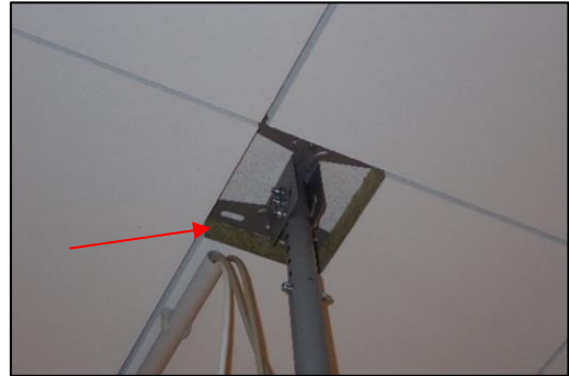
Kuva 6. Tila 101. Akustiikkalevyissä on paikoin avonaisia villapintoja.
