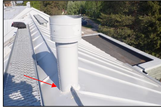
Kuva 88. Läpivientien tiivistysmassauksissa halkeilua.
