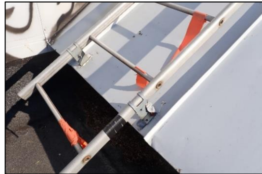
Kuva 90. Lapetikkaat kiinnitetty katteen läpi. Tiivisteet syytä tarkastaa ja vaihtaa tarvittaessa.
