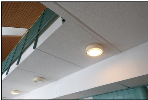
Kuva 24. Tila 103. Liikuntasauaman toteutus on puutteellinen ja aiheuttanut halkeaman laatasaa.
