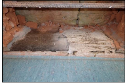
Kuva 50. RA1. Muurauksen ja perustuksen välissä bitumikermi.
