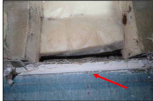
Kuva 42. RA6. Alapohjalaatta valettu kipsilevyä vasten. Liittymän kautta ilmavuoto on mahdollista.
