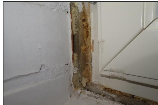
Kuva 54. RA2. Tilkkeenä polyuretaanivaakto. Ikkunakarmin ja muurauksen väli avoin eristetilaan.
