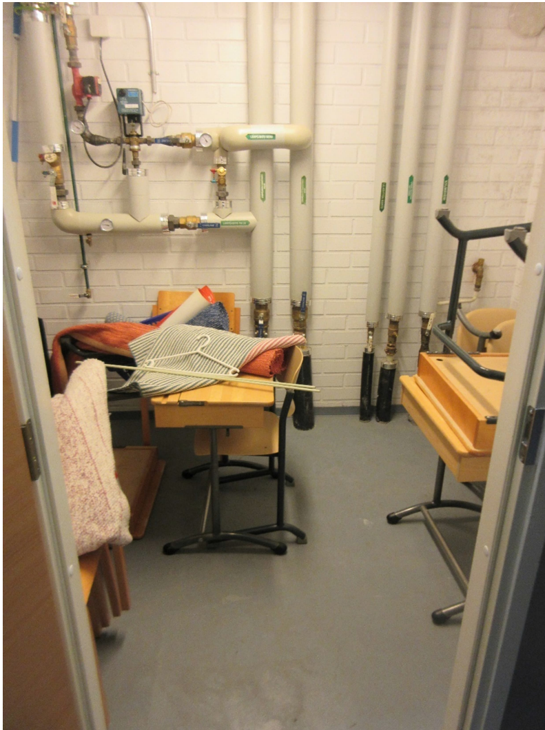
KUVA 3. Lämpö- ja vesiputket nousevat vuonna 1998 rakennetun koulun lämmönjakuhuoneeseen. Rakennuksen patterilämmityksen pumppuryhmä seinällä. Lämpöputket jatkuvat ilmanvaihdon konehuoneeseen.
