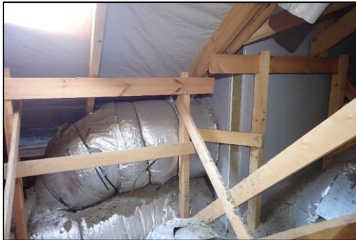
Kuva 101. Vuotojälkien kohtaa ei voida tarkastaa yläpohjasta rakenteita purkamatta.
