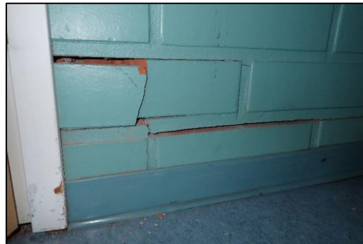
Kuva 4. Tila 103. Perustusten ja alapohjan painuma on aiheuttanut halkeamia väliseinä-, ala-, ja välipohjarakenteissa.
