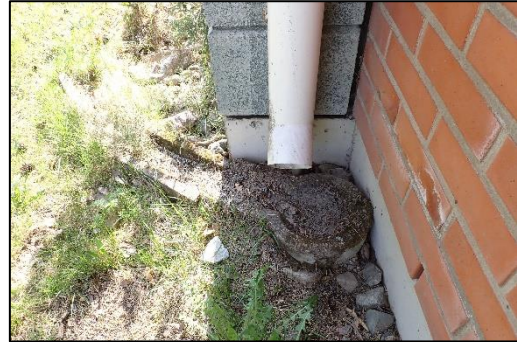
Kuva 16. Sadevesiä on johdettu rakennuksen vierelle. Sadevesien ohjaus puutteellinen, mikä aiheuttaa paikallista rasisusta perustusrakenteille.
