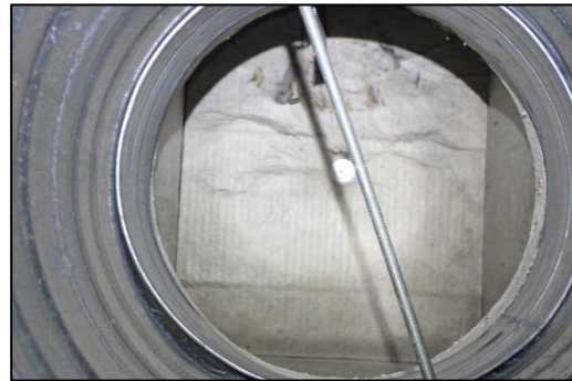
Kuva 110. Tila 200. 2. kerroksessa päätelaitteissa on alkuperäiset villavaimentimet.
