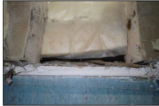
Kuva 64. RA6. Alapohjalaatta valettu kipsilevyä vasten. Höyrynsulkumuovi päättynyt perustuksen pintaan.
