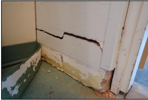
Kuva 22. Tila 109. Tiiliseinän halkeama alapohjalaatan painuma seurauksena.
