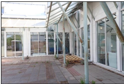
Kuva 97. Teräsrungoissa yleisesti pintakorroosiota.
