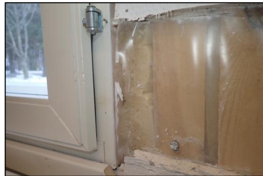
Kuva 62. RA5. Muovi on tuotu karmin reunaan. Ilmavuotoa voi liittymän kautta seinärakenteesta tapahtua.
