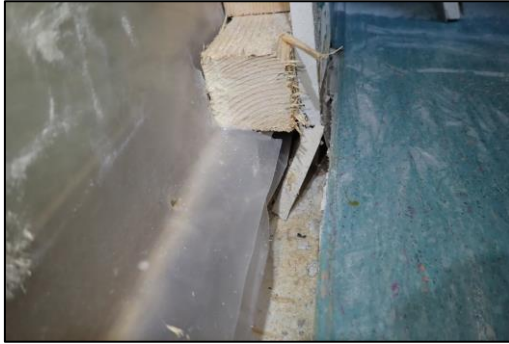
Kuva 69. RA7. Rakenne liittymä on avoin maaperään ja ilmavuoto on todennäköistä. Höyrynsulku päättyy perustuksen pintaan.
