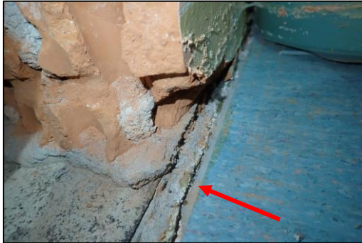
Kuva 41. RA3. Ilmarako alapohjan ja ulkoseinän liittymässä.
