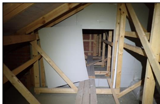
Kuva 108. Yhden palokaton kohdalla seinälevy oli irti. Ilmoitettu kiinteistöhuollolle.
