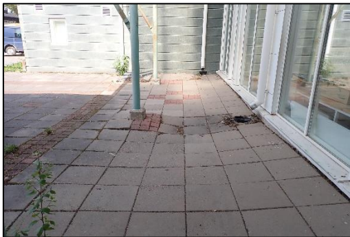
Kuva 11. Rakennuksen vierellä huomattavaa maanpainumaa, alue esitetty liitteessä 1.
