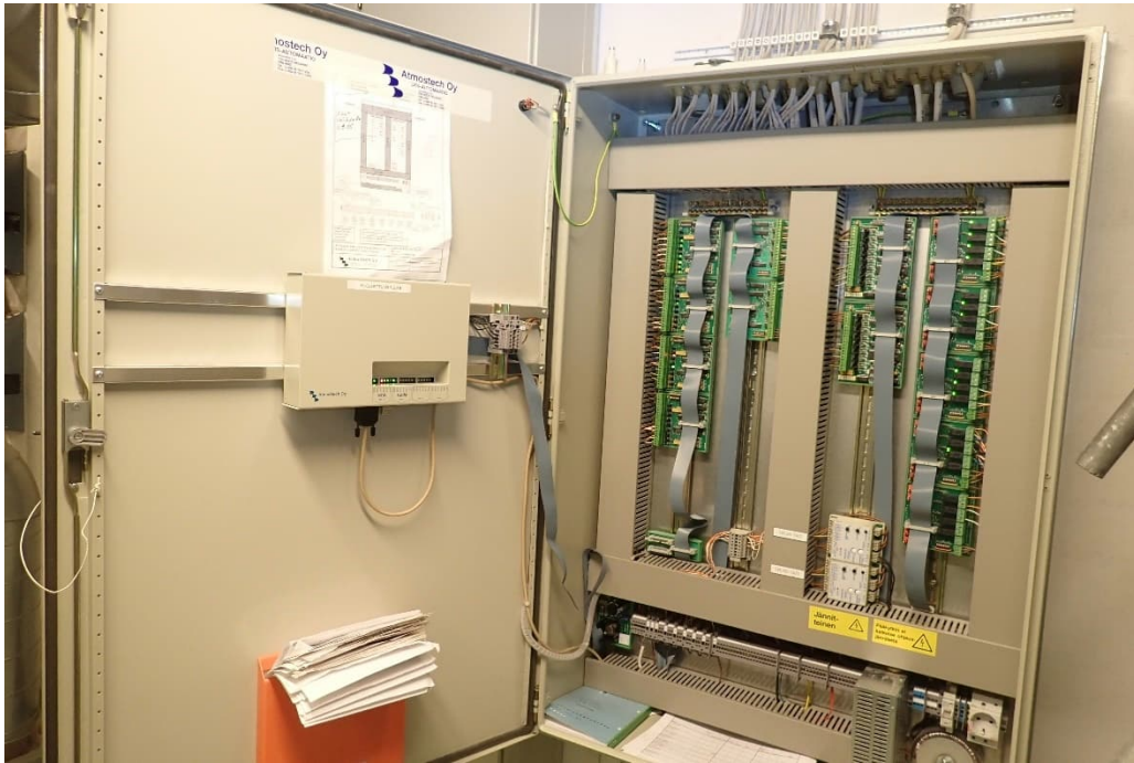
KUVA 6. Ilmanvaihtokonehuoneessa sijaitseva valvonta-alakeskus VAK 165.
