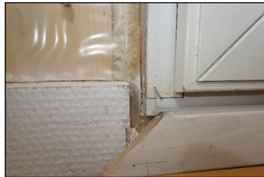
Kuva 80. RA10. Muovi on tuotu karmien reunaan. Ilmavuotoa voi liittymän kautta seinärakenteesta tapahtua.
