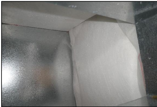
Kuva 109. Tila 110. 1. kerroksessa päätelaitteiden äänenvaimentimet on havaituilta osin vaihdettu.
