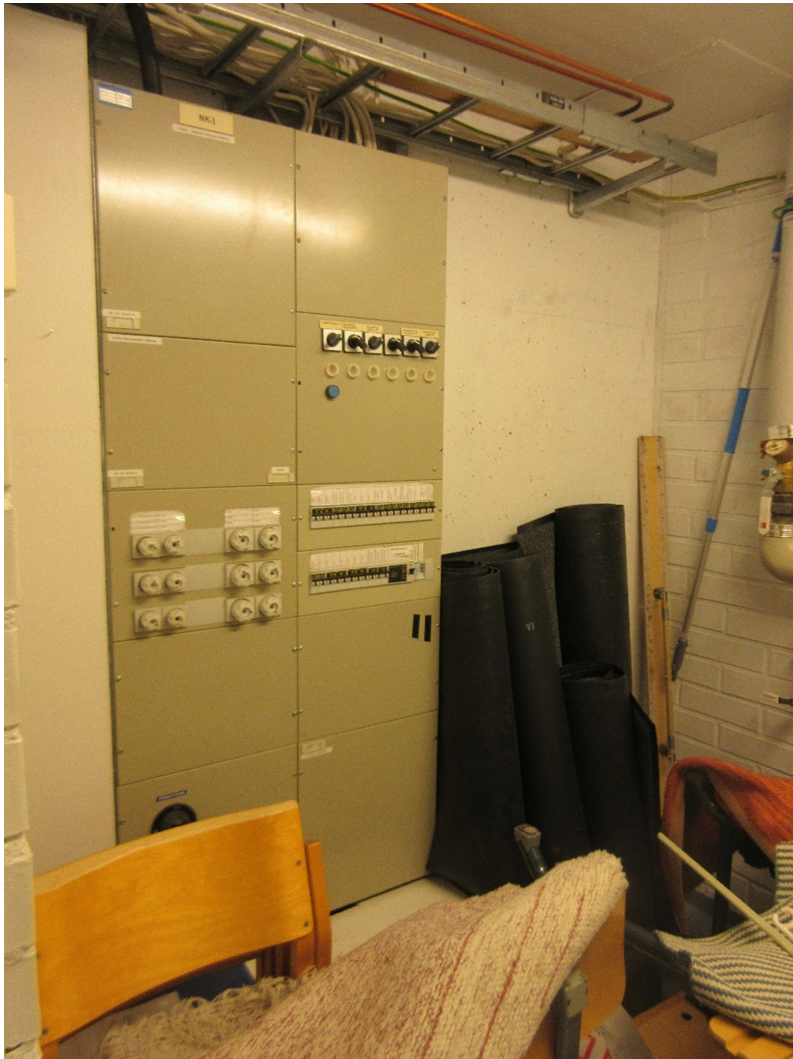
KUVA 8. Nousukeskus NK-1 lämmönjakuhuoneessa.
