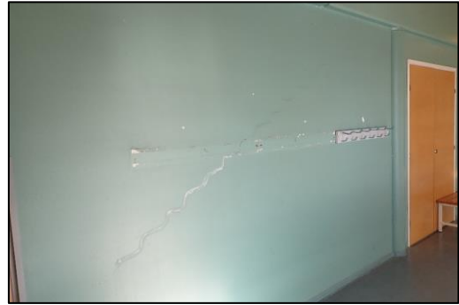
Kuva 23. Tila 218. Perustuksen / alapohjalaatan painuman seurauksena muodostuneita halkeamia väliseinässä 2. kerroksessa.
