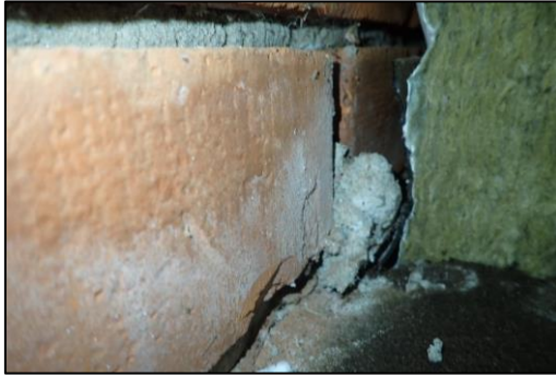
Kuva 57. RA3. Tuuletusraossa vähäisesti laastipurseita.
