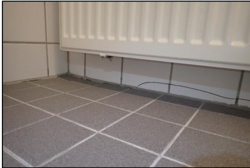
Kuva 5. Tila 124. Märkätilan laatoitus halkeilee todennäköisesti alapohjan painuman seurauksena.
