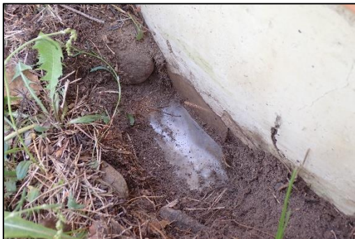
Kuva 13. Kiveyskaistan alla rakennusmuovi. Perustuksen ulkopinnassa ei havaittu kosteuseristystä tai perusmuurilevyä.
