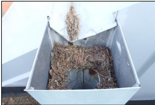
Kuva 89. Sadevesijärjestelmät paikoin roskaiset.
