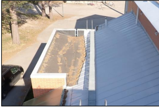
Kuva 93. Tasakatoilla paikoin puunroskaa.
