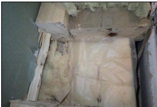
Kuva 65. RA6. Alaohjauspuun alla mineraalivillakaista. Villakaistassa viitteitä poikkeavasta mikrobikasvusta. Puurakenteet hyväkuntoisia.
