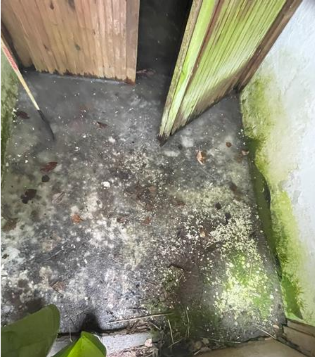
Kuva 13. Eteiskäytävän metallinen ulko-ovi. Maanpinta ja maatäytöt estävät ovien avautumisen. Eteiskäytävän lattia maanpinnan alapuolella.
