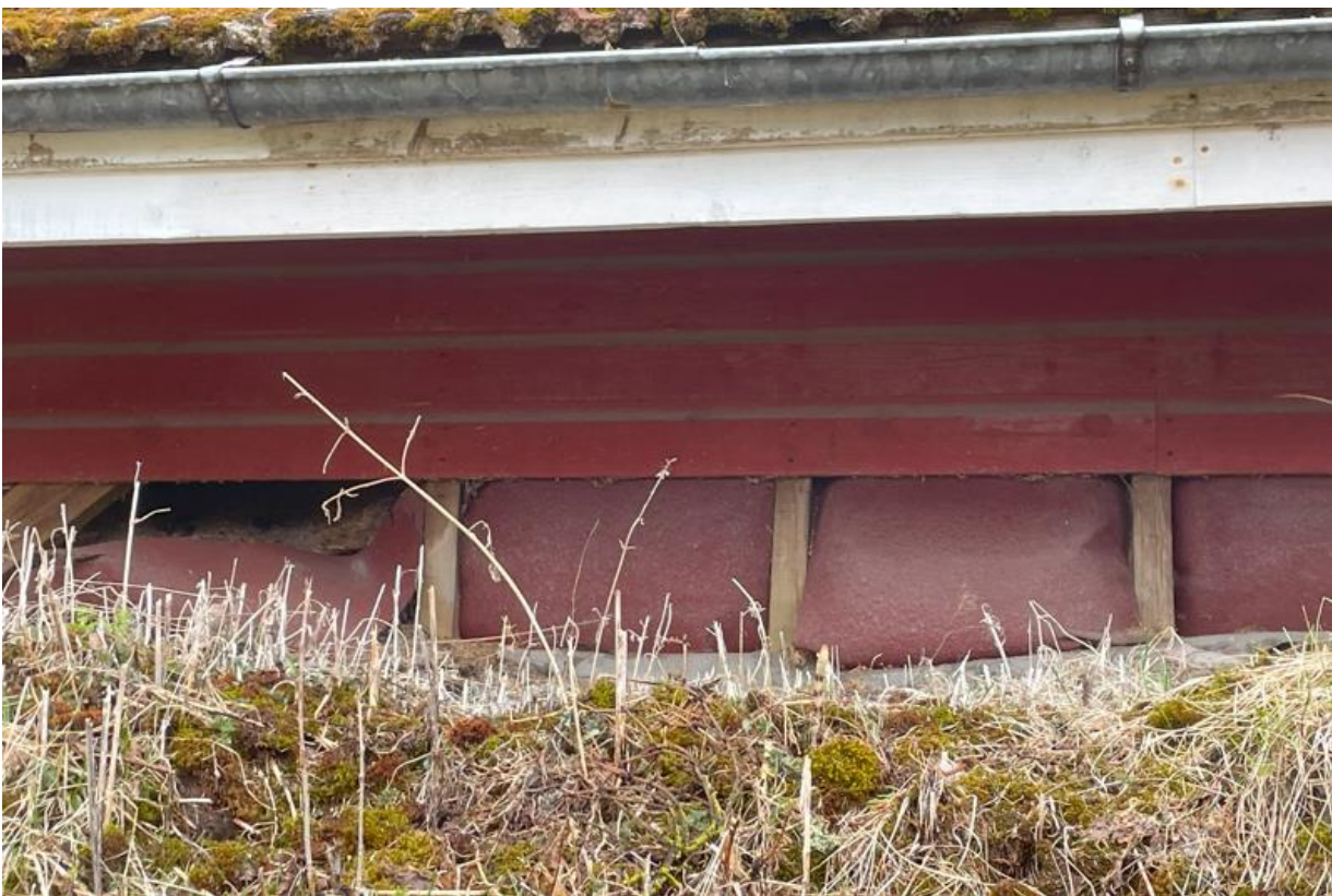
Kuva 10. Bitumikermisuikaleet käpertyneet. Vaakalaudoitusta puuttuu.
