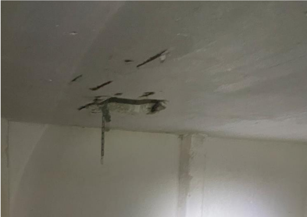
Kuva 22. Maakellarin ilmanvaihtoaukko katossa.
