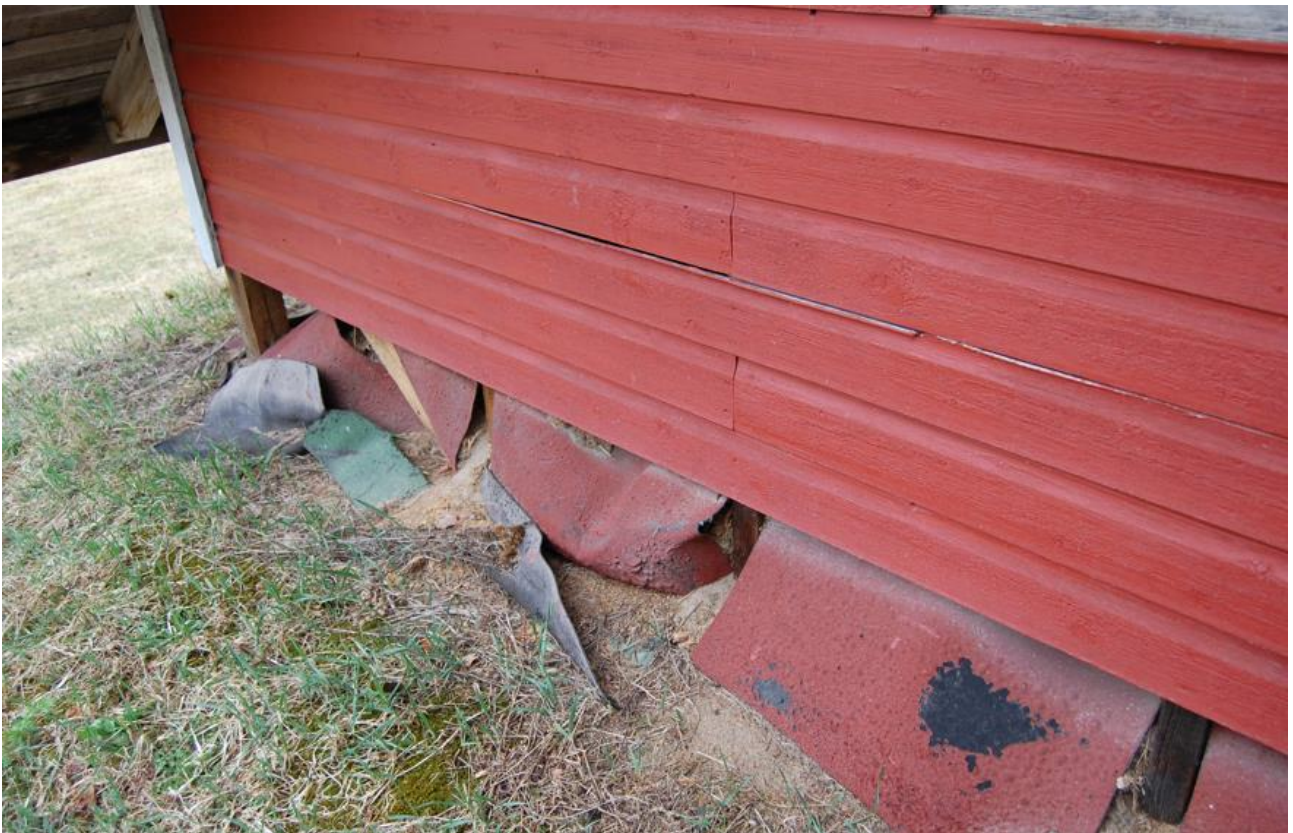
Kuva 8. Bitumikermisuikaleet ovat käpertyneet. Vaakalaudoitus puuttuu osittain.
