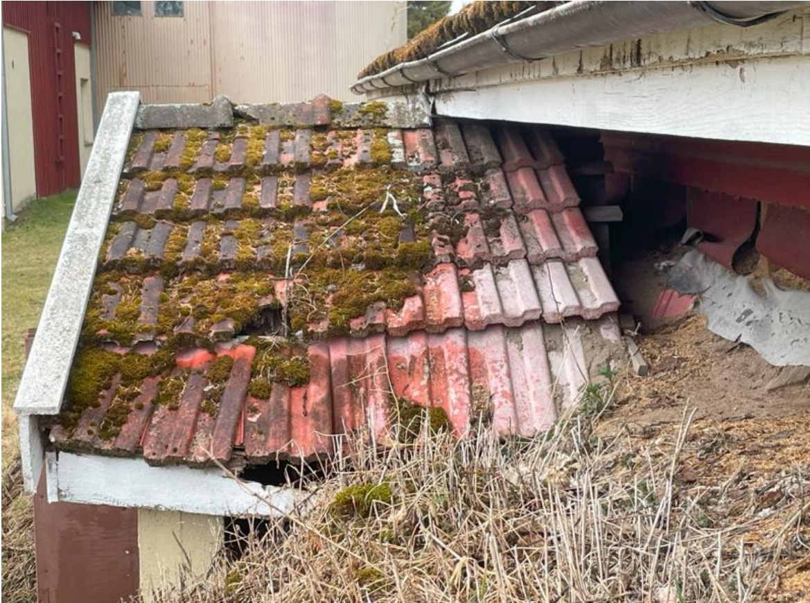
Kuva 14. Eteiskäytävän murtunut ja vajavainen tiilikatto. Maatäytön ja katon välistä kosteus pääsee seinärakenteeseen.
