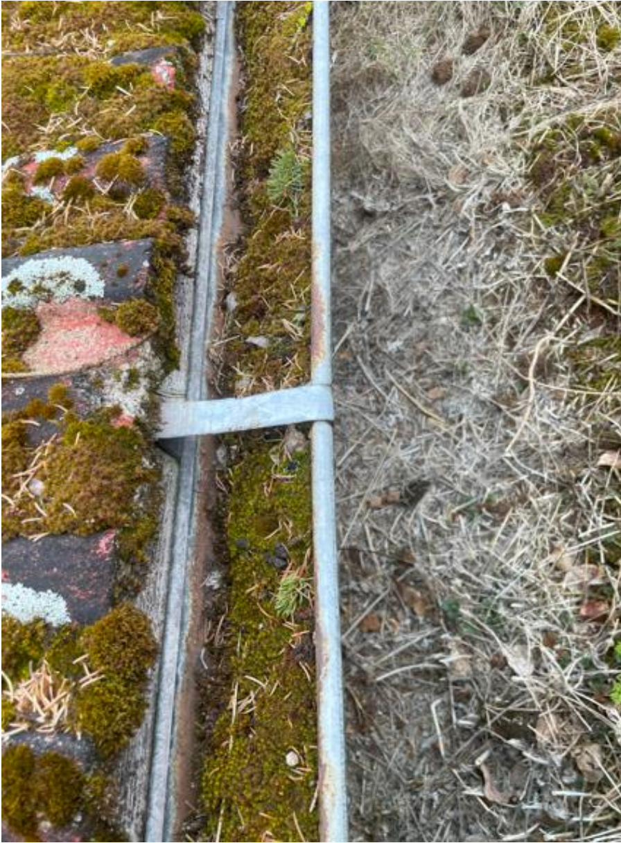
Kuva 20. Räystäkouru täynnä sammalta.
