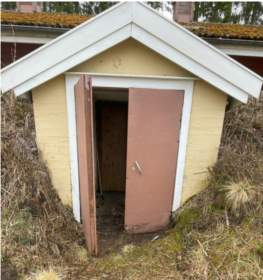
Kuva 12. Eteiskäytävän metallinen ulko-ovi. Maanpinta ja maatyöt estävät ovien avautumisen. Eteiskäytävän lattia maanpinnan alapuolella.
