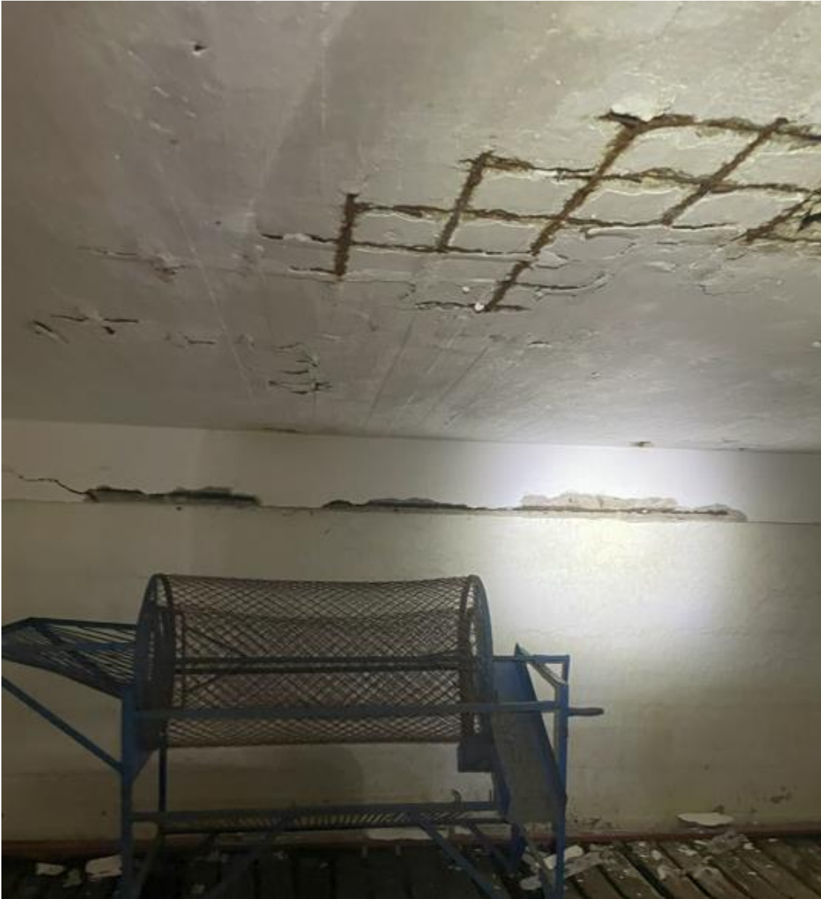
Kuva 28. Seinässä ja katossa ruostunutta teräsverkkoa.
