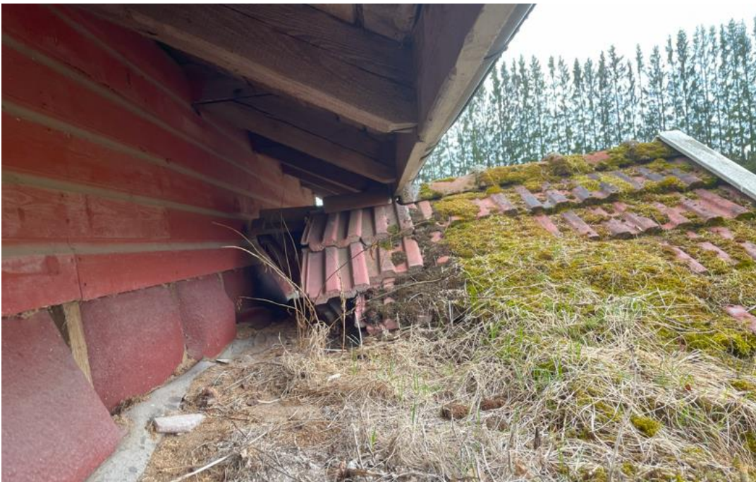
Kuva 15. Eteiskäytävän murtunut ja vajavainen tiilikatto, virheellinen rakenne. Maatäytön ja katon välistä kosteus pääsee seinärakenteeseen. Tiilikatto on huonokuntoinen.
