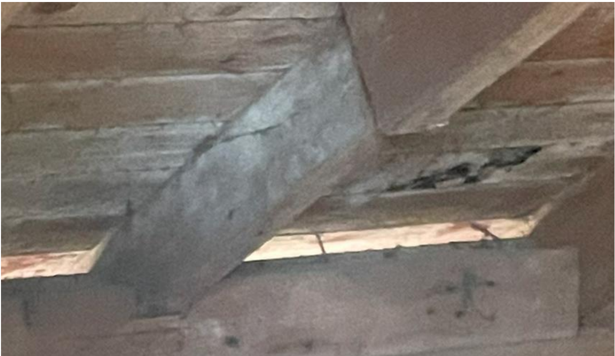
Kuva 19. Umpilaudoituksen kosteusvaurioita yläpohjassa.
