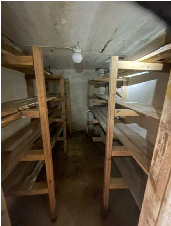
Kuva 31. Märkä lattia ja vaurioita katossa.
