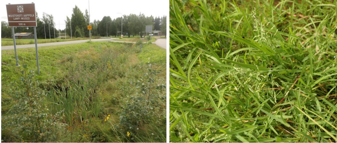
Kuva 11. Pappilantien sivuojassa havaittiin vesihilpeä.
